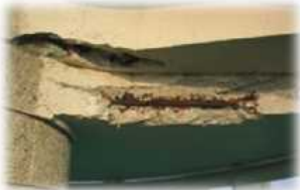
Corrosion des armatures du béton
