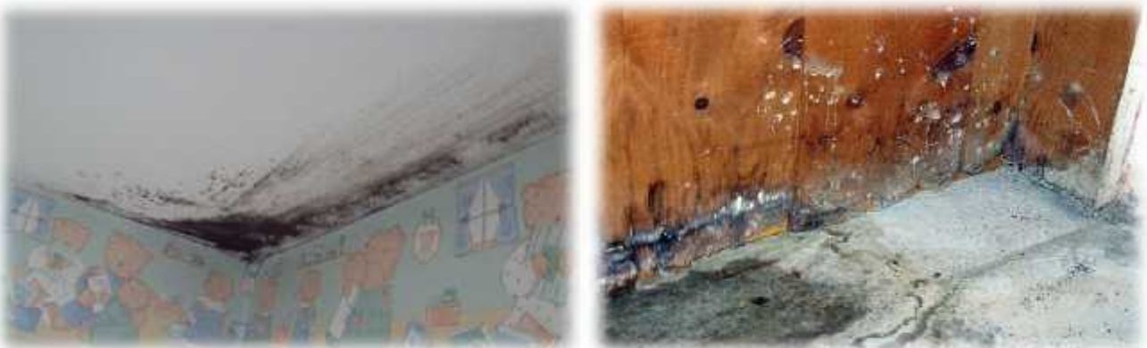
Champignons d'humidité sur les murs et les plafonds
