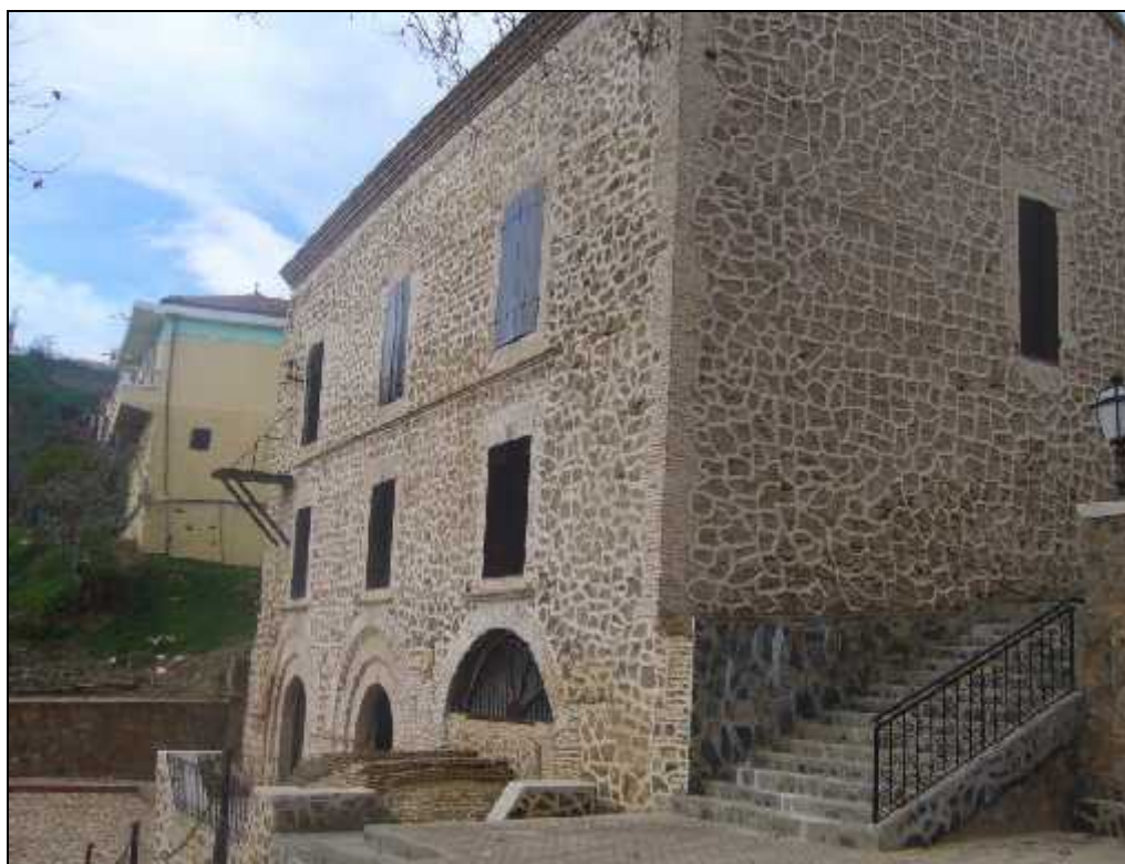
Fig.2. 36 _ Vue sur façade latérale de l'Atelier et façade latérale de la maison après restauration. Photo prise par l'auteur en aout 2015.
