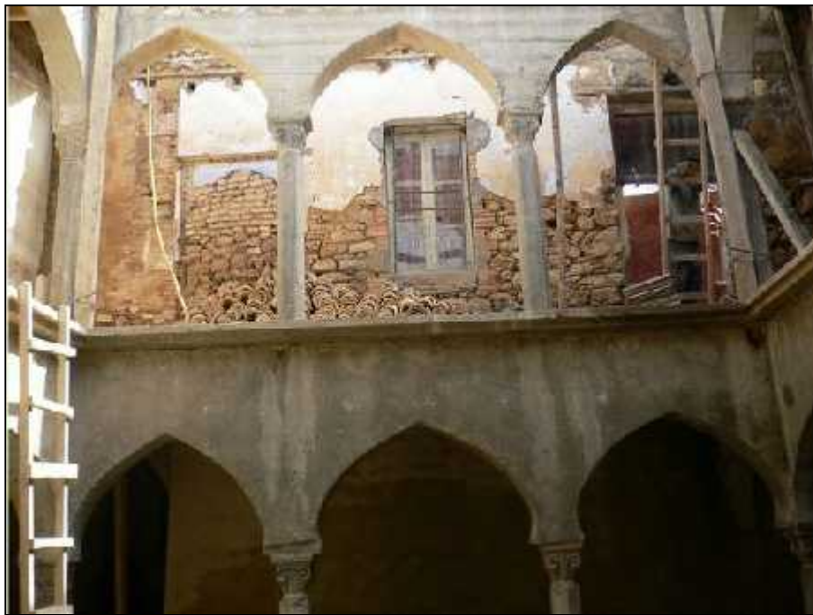
Fig.2. 31 _ Vue sur le patio de la maison lors des travaux de restauration. Photo crédit www.algeriemiliana.com
