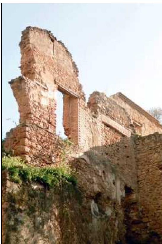
Fig.2. 24 _ Vue sur les parois extérieures de la manufacture d'armes avant restauration. Photo : crédit www.algeriemiliana.com .
