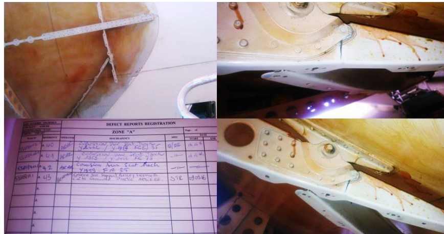
Figure I.3 : détection de corrosion au niveau des portes des cabinets sanitaires
