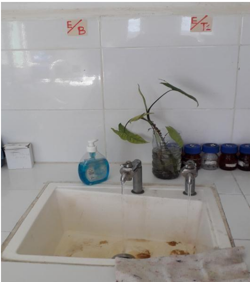
1. Robinet d'accès à l'eau brute
