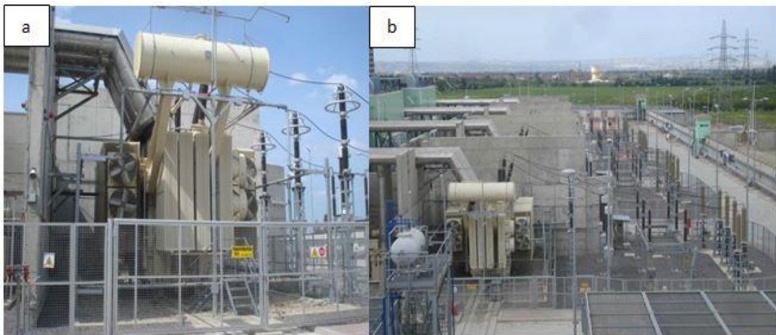
Figure 7: a Transformateur principal, b Station d'évacuation d'énergie électrique.
