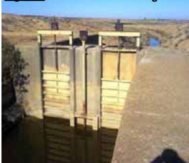
Fig. 66 : Les vannes du barrage
