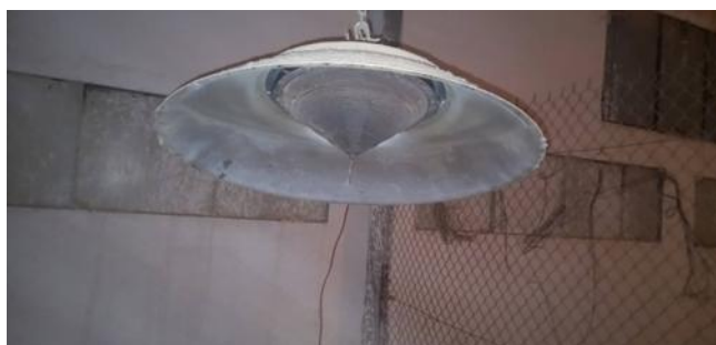
Figure 05: Système de chauffage « radiant à gaz propane »
