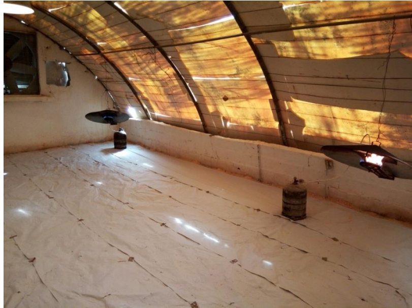
Photo n°6 : radiants du chauffage.
