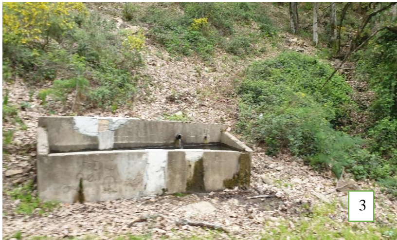
Figure 46 : Photos 02 et 03 du captage de la source et sa déviation de son itinéraire naturel causant la dégradation du Taxus baccata photo 01 (originales).
