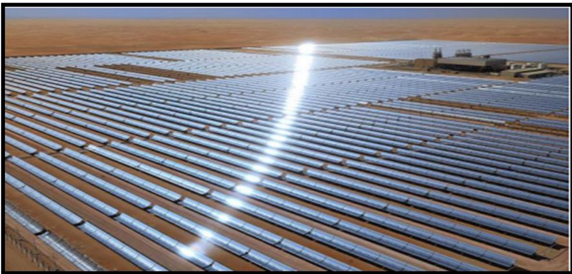
Figure. 21. : panneau photovoltaïque Source : https://www.fichier-pdf.fr/2014/04/11/masdar/masdar.pdf
