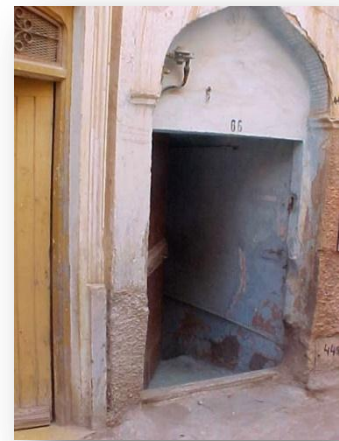
figure2.6 Traitement de la porte d'entrée d'une maison mozabite à Ghardaïa (2005) Source (Google image)
