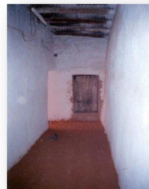
Figure2.7. Traitement de la porte d'entrée d'une maison mozabite à Ghardaïa (2005) Source (Google image)
