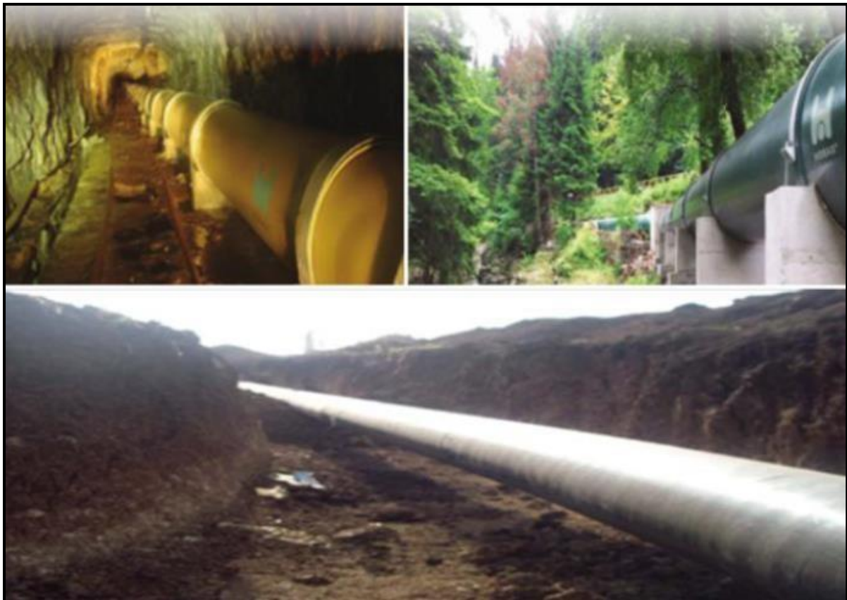
Figure I.1 : Pipeline dans l'environnement[3].
