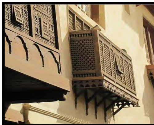
Figure 11: L'extrusion du Moucharabieh qui permet à l'air de trois côtés d'entrer. Source : www.atelierdesorient.com
