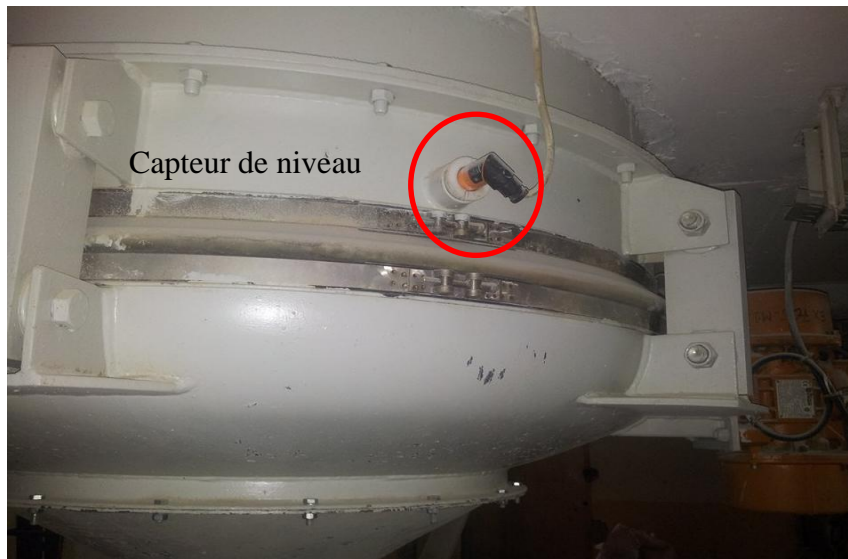
Figure 2.1. Capteur de niveau.
