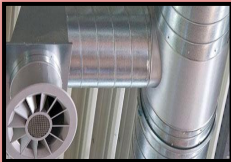
Fig.16:le système d'extraction de fumées
