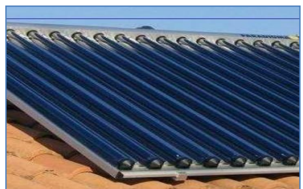
Figure I-36-: panneau solaire thermique (1)
