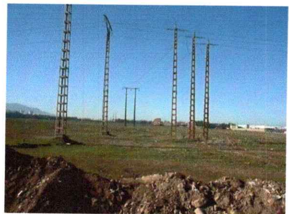
Figure3.51 Réseau électrique moyenne tension aérienne
