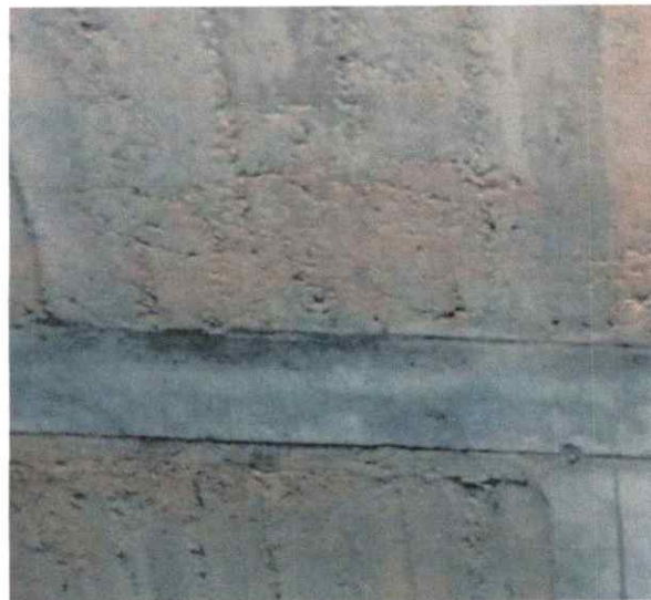
Fig. 53 : béton banché utilisé dans le centre culturel Source : photo prise par l'auteur
