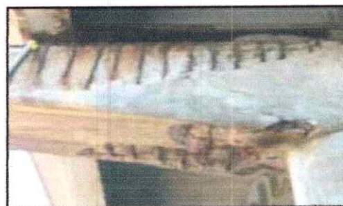
Figure1 : phénomène de corrosion d'un poteau en béton armé Src : Auteur 2016
