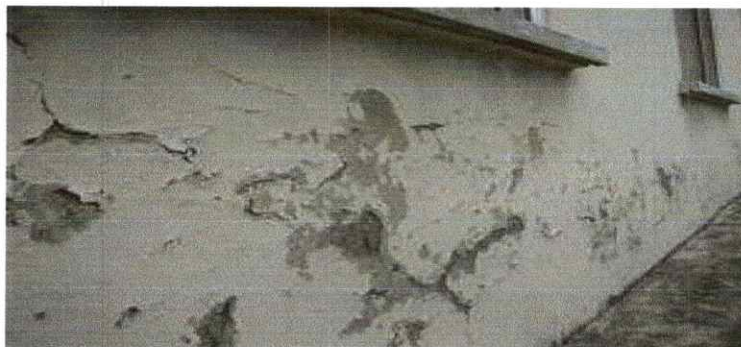
Figure 10 : photo présent le risque de la pluie et de l'humidité sur les matériaux.
