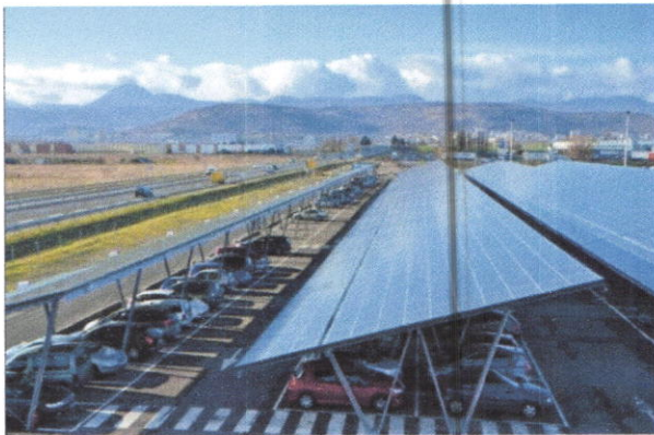
Figure 60 : abris solaires de parking Source : Jaques V, 2015
