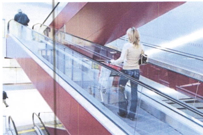
Figure 53 : trottoir roulant incliné
