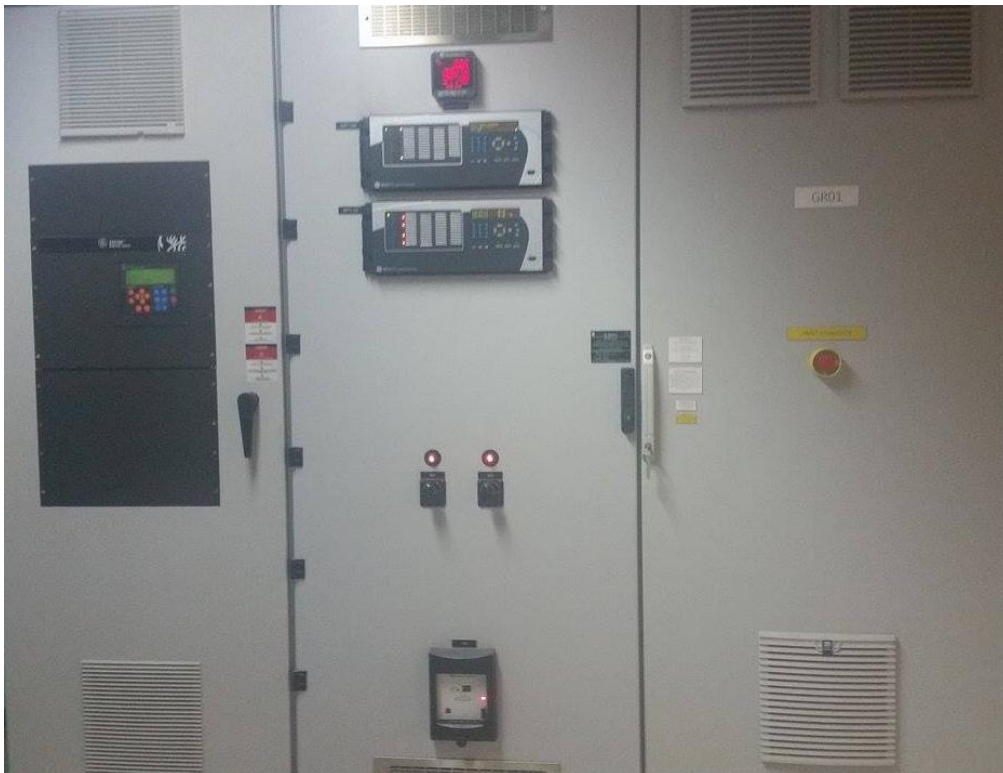
Figure 2.18: armoire de contrôle du système Marck VI.
