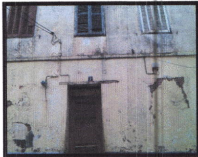
Figure n°98 : Habitat colonial en état vétuste source: photo prise par étudiant
