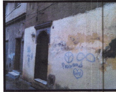
Figure n°99 : Habitat Ottoman en état vétuste source: photo prise par étudiant
