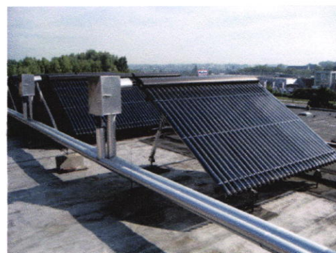
Figure 31 Des panneaux solaires installés sur le toit de hôtel
