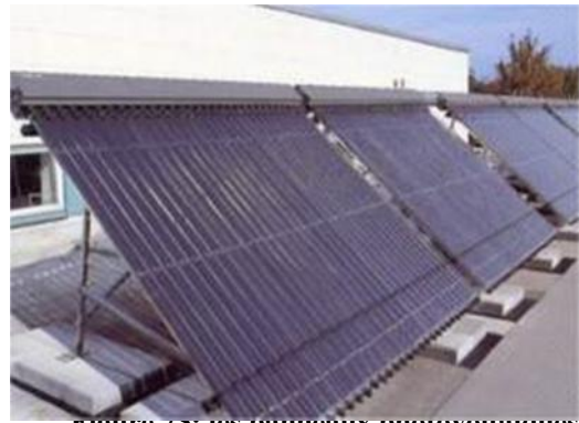
Figure 73: les panneaux photovoltaïques
