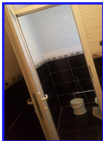
FIG 136 : WC Source : l'auteur
