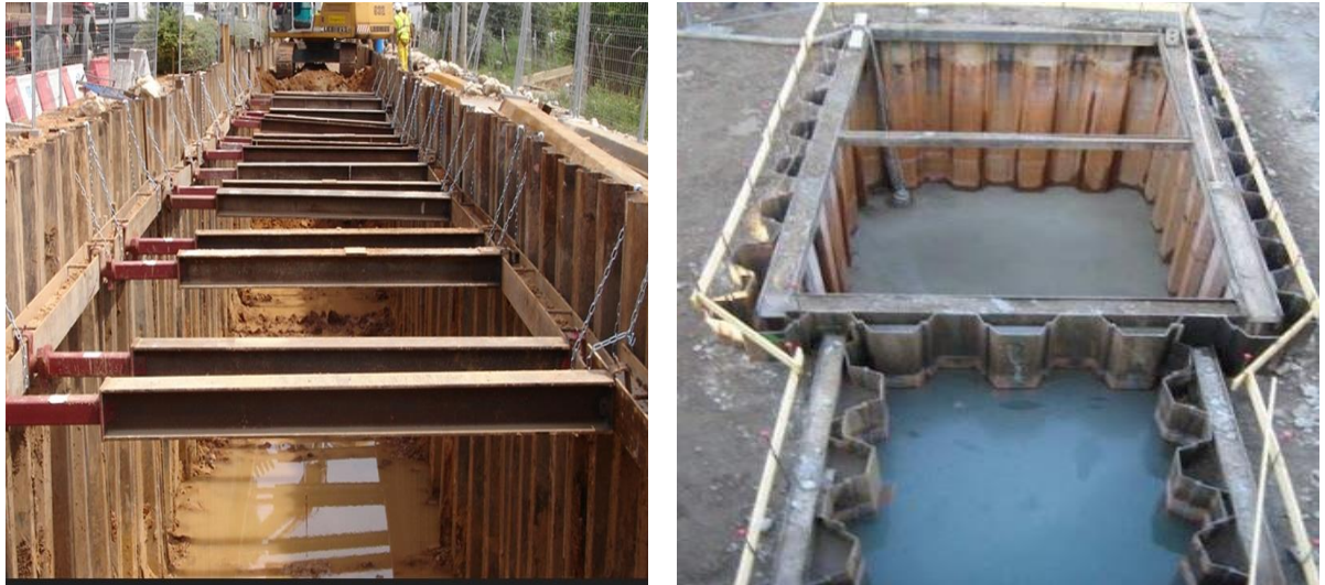
Figure I. 13 : A gauche : Blindage de fouille. A droite : Réalisation d'un mur de quai composé de rideaux de palplanches.
