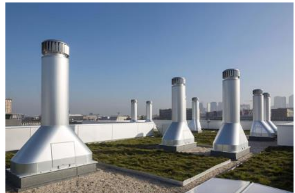
Figure II.34. Des cheminés pour la ventilation Source : http://conseils.xpair.com
