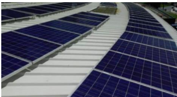
Figure II.20 : Panneaux photovoltaïques Source : http://conseils.xpair.com
