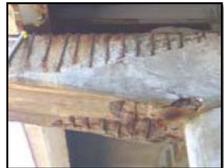
Figure30 :L'humidité cause de graves dommages sur la structure d'une construction
