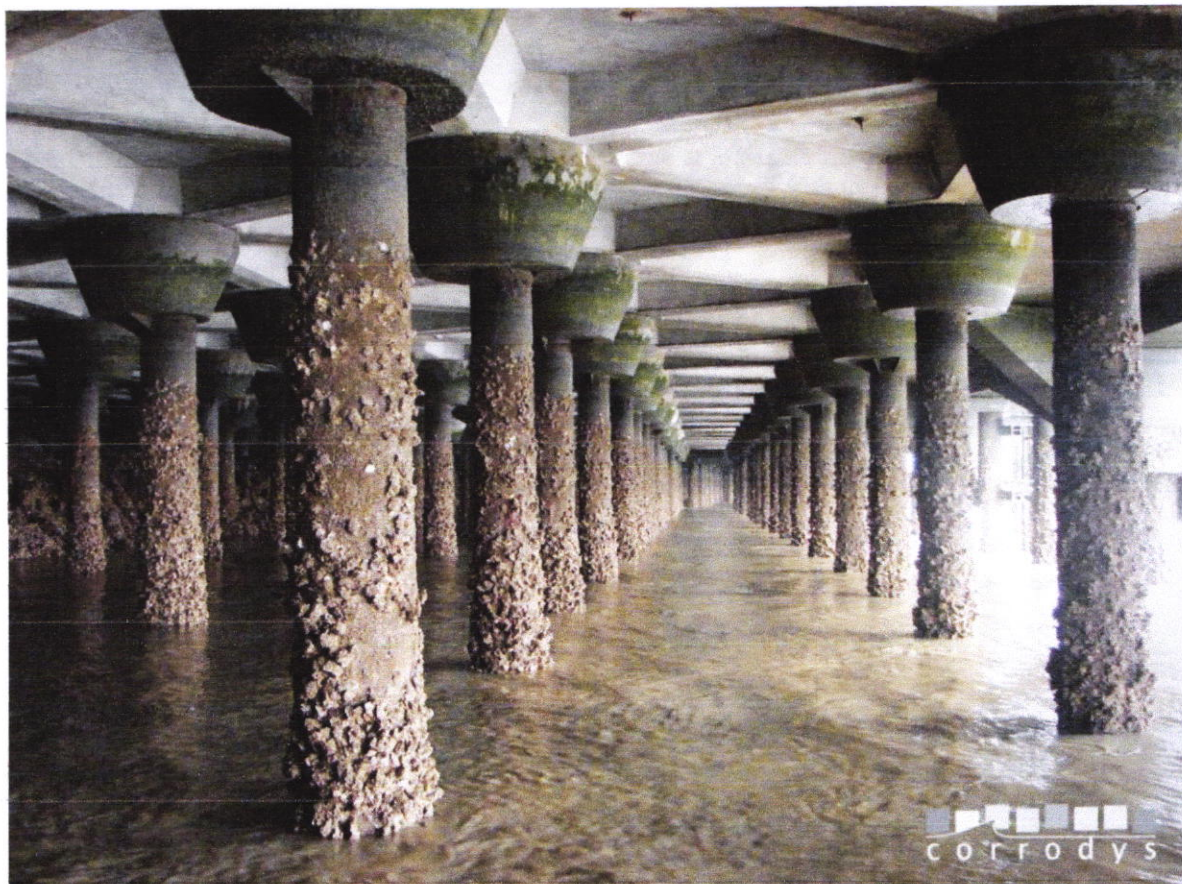
Figure 17 : Phénomène de corrosion.
