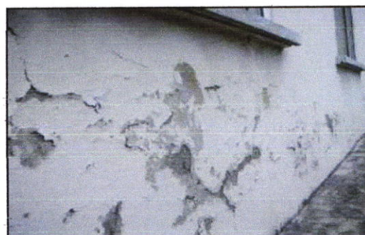
Figure 34. Détérioration des matériaux par l'humidité Source : www.Hydro-Style.com
