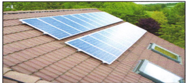
-figure45: panneaux photovoltaïques.
