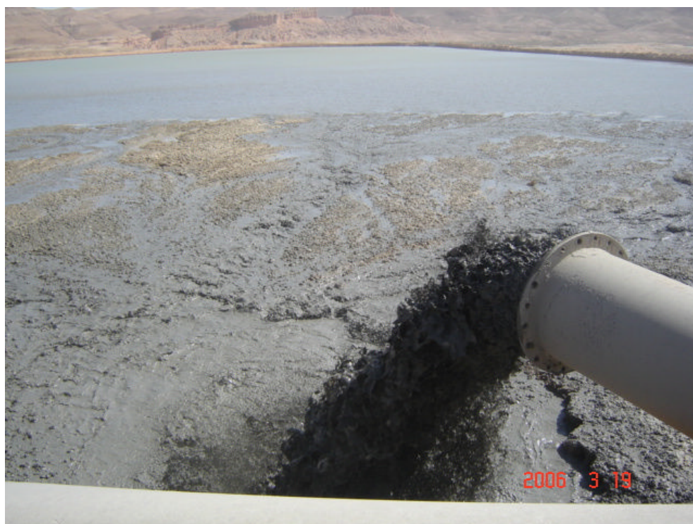
Figure 4.11: Rejet de la vase dans les bassins de décantation.
