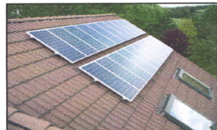
Figure 35 : Panneaux photovoltaïques Source : www.NormeBBC.fr
