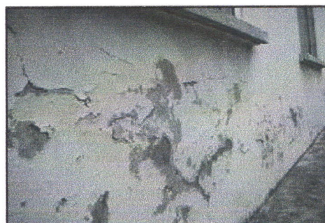
Figure 48 : Détérioration des matériaux par l'humidité Source : www.Hydro-Style.com
