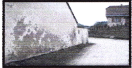
Figure1 : l'impact de l'humidité sur les murs
