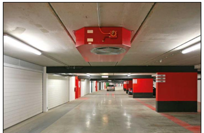
Figure 149: système de ventilation dans le parking source www.pinterest.com )
