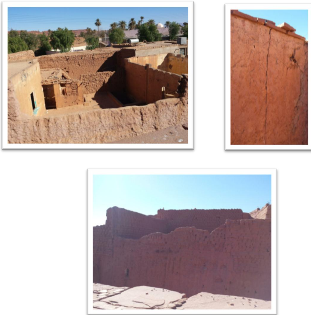
Figure2.29 :Etat de dégradation du ksar (H. Ait Saadi, et all, 2017)
