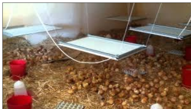
Figure 87 Chauffage à rayonnement infrarouge dans un poulailler (Airchaud diffusion)
