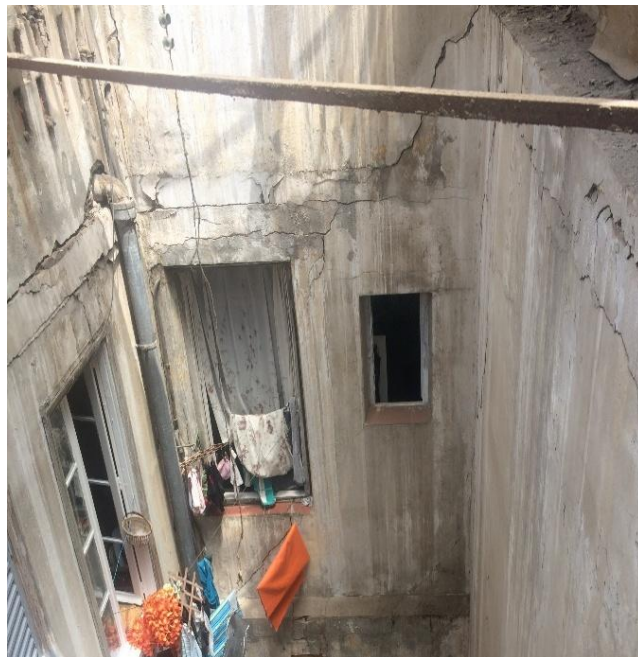
Figure 12 : Photo sur les pathologies du patio du 01 Ahmed CHAIB
