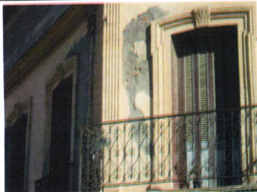
Fig2.21: Utilisation de ciment non homogène avec la pierre
