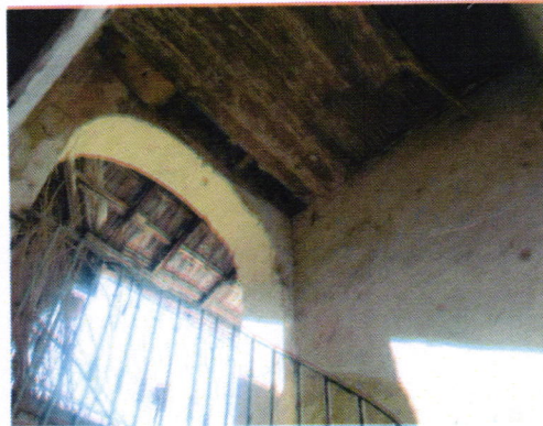
Fig2.22: Toiture en état très dégradé
