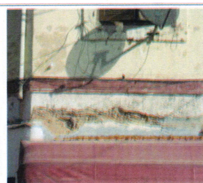
Fig2.24: dégradation de linteaux
