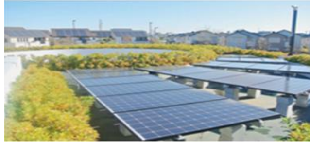
Figure 49 ;les panneaux photovoltaïques
