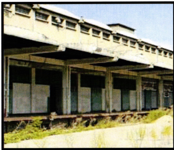
Figure 4 : bâtiment en état de friche
