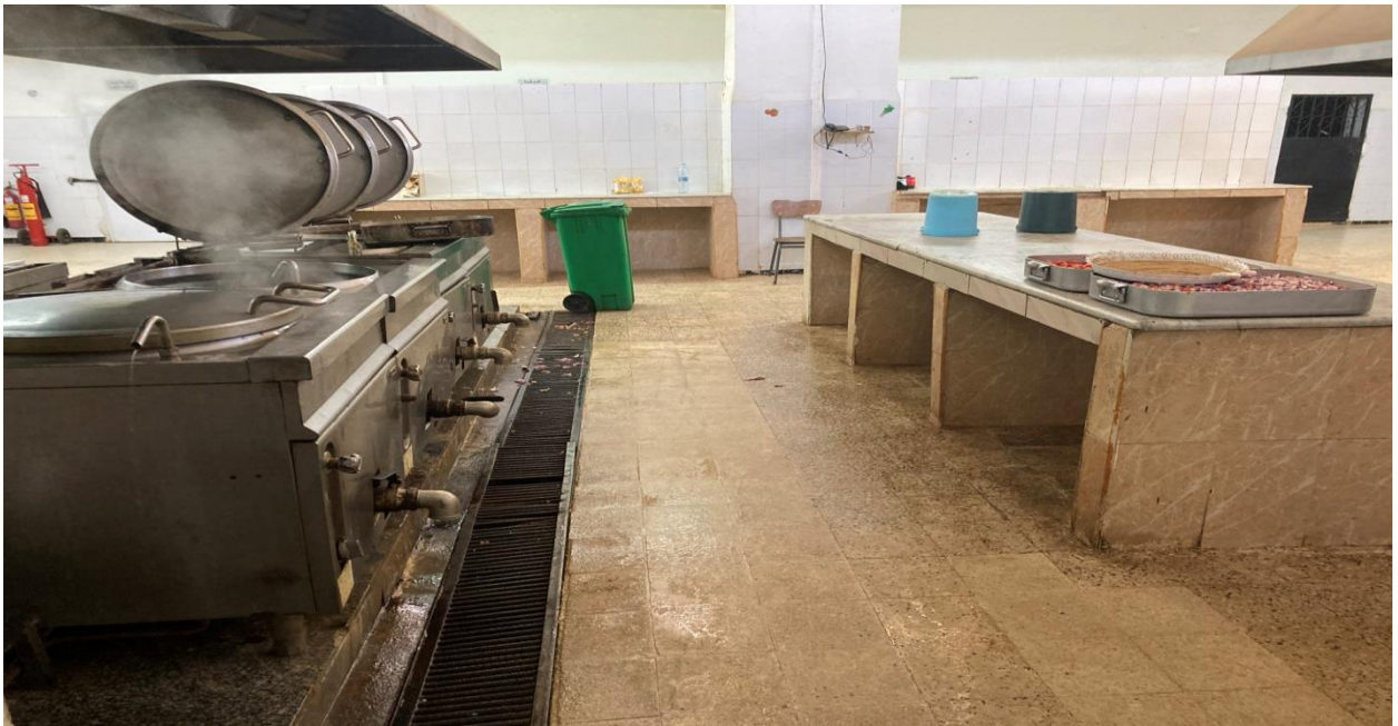
Figure 20 : le bloc de cuisson du restaurant collectif
