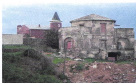
L'état de dégradation avancé des villas.
