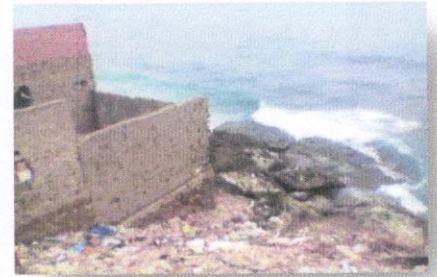
L'état de bâti au bord de la mer .
