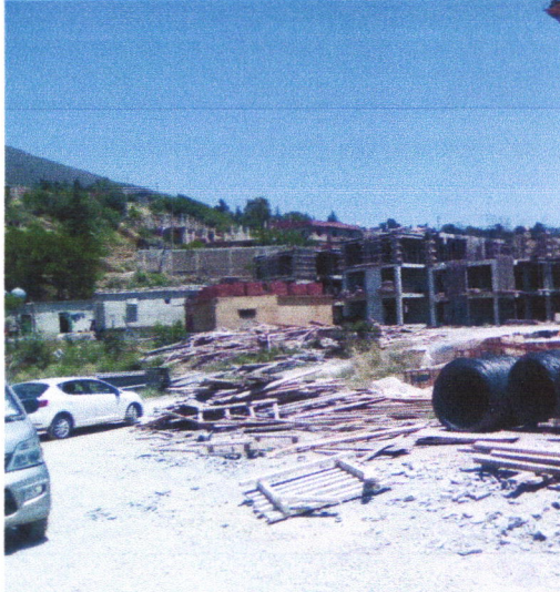
FIG 31 :travaux de 254 logements a sisi sbaa en cours Source : photo prise par l'auteur
