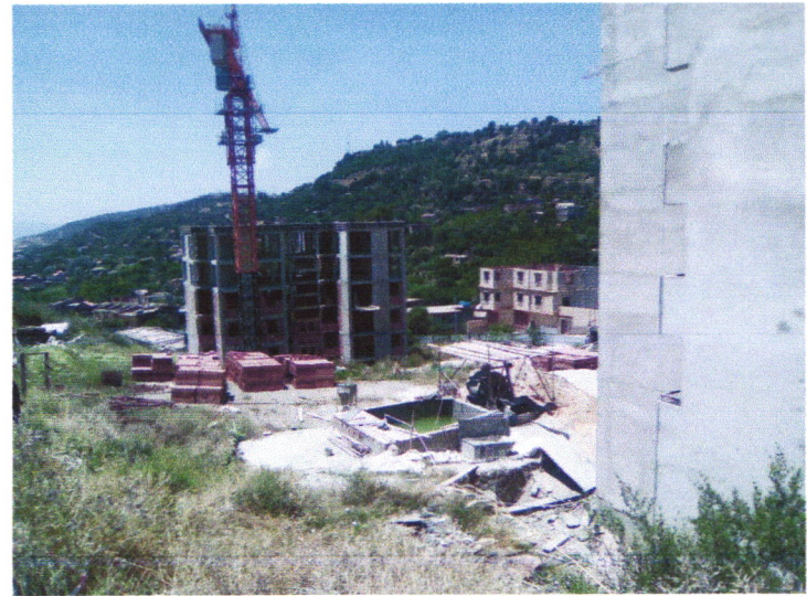
FIG 32 : travaux de 254 logements a sisi sbaa en cours Source : photo prise par l'auteur
