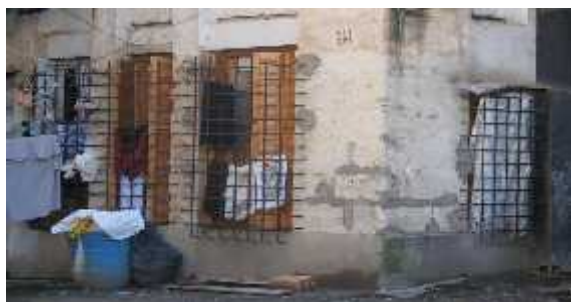
Figure 32 : fenêtre à Diar el mahçoul Source : Google image
