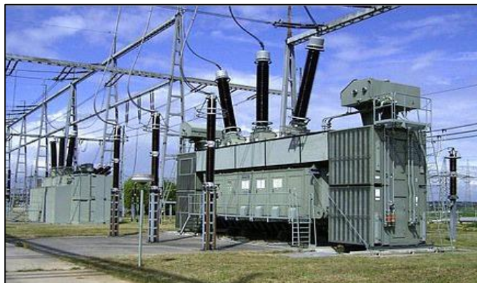
Figure I.11 Transformateur de puissance
