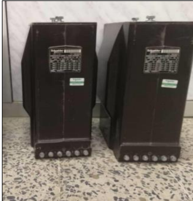
Figure I.10 Transformateur de courant
