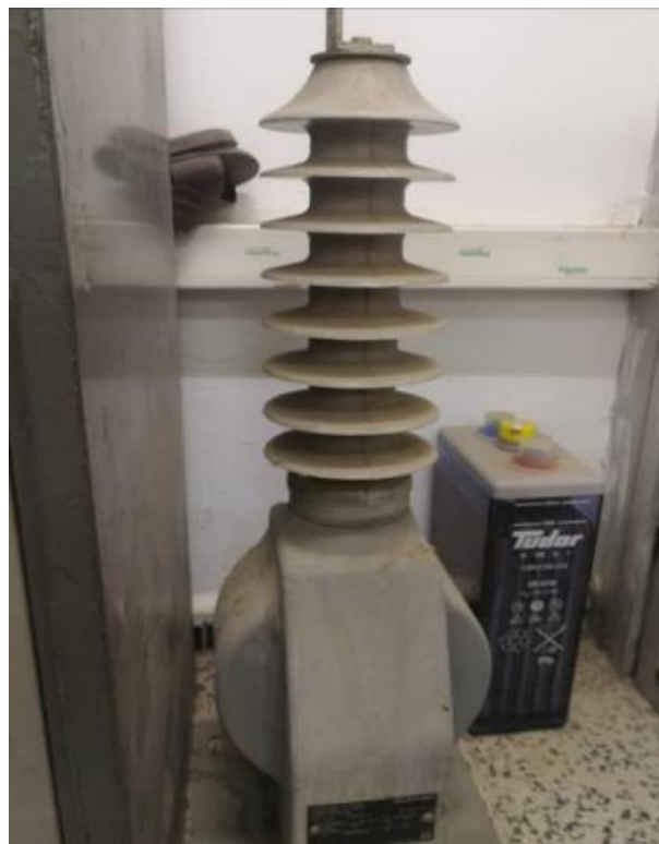
Figure I.9 Transformateur de tension
