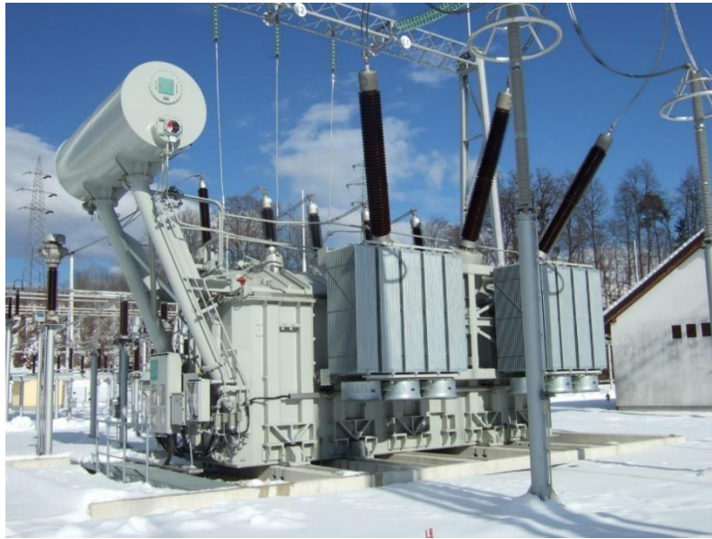
Figure 4.37 : Une image sur le transformateur d'une centrale électrique
