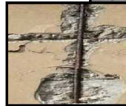
Fig3: Corrosion de béton
