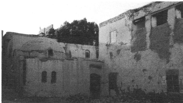
Fig.2.26 Habitation en dégradation à Gourná
